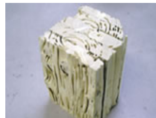
シロアリに食されたホワイトウッド集成材(SPF 集成材)一般的な木造住宅で使用されています
